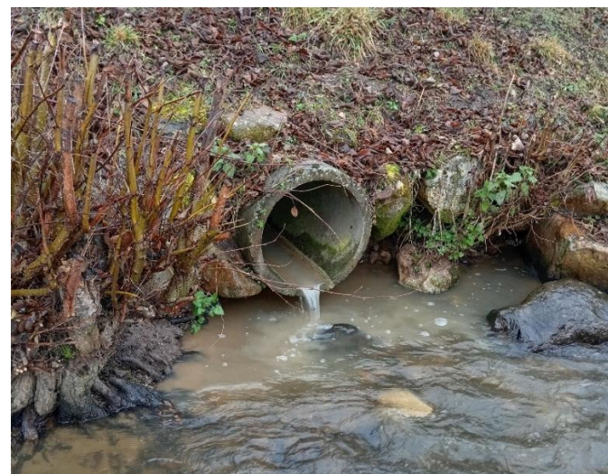
Figure 10 : Rejet d'eaux usées direct dans le cours d'eau
